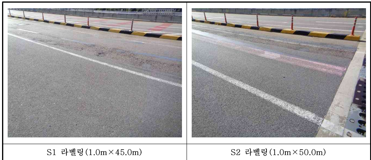
【사진 1.3.20】 교면포장 손상현황
